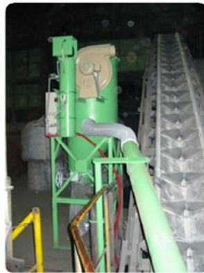
クライマーコンベア下部に設置
