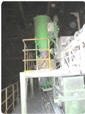
クライマコンベア上部に設置
